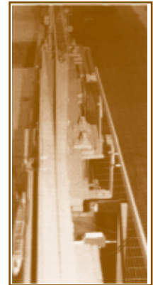
Installazione del sistema di controllo ruote effettuata nel sito FS di Napoli Gianturco
