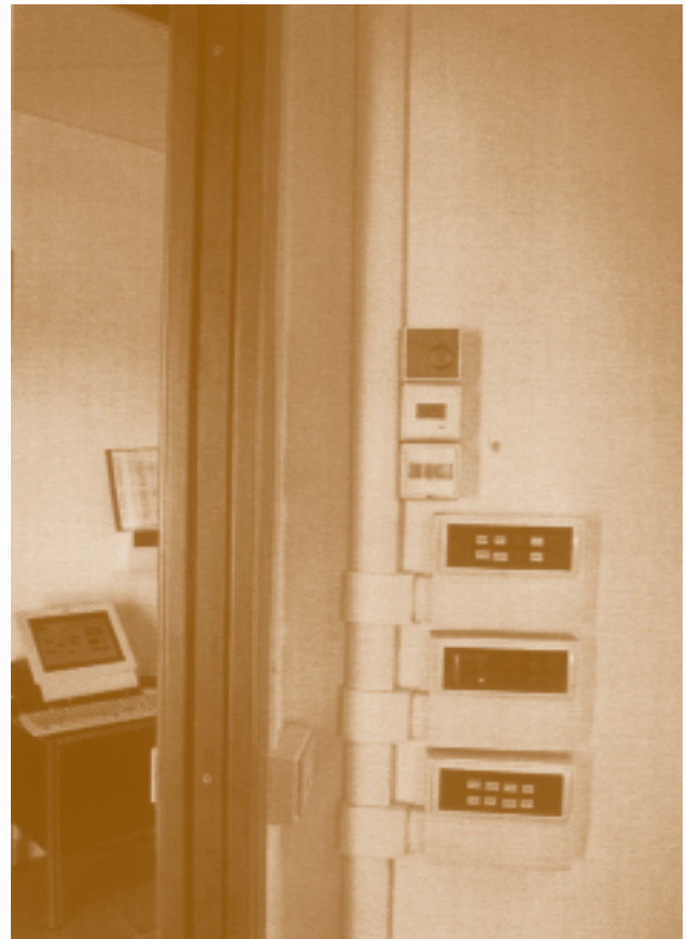
Fig. 1 - Strumentazione per il controllo intelligente del complesso
